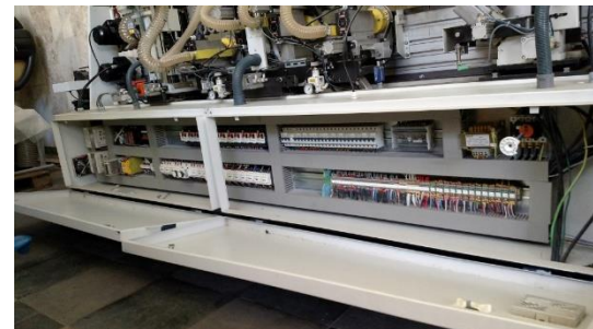
DETALHE PAINEL ELÉTRICO
